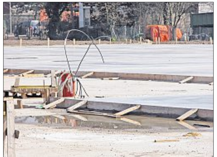
Auf einer Fläche von etwa 15 000 Quadratmetern entstehen in der Hohenhorster Bauerschaft die Neubauten. Flinkert
